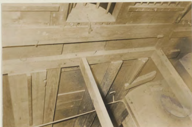
die zwei äusseren der 3 Träger der HW-Lade C-Seite N4 Mitte oben Prospektstock
